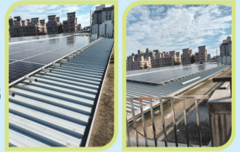
頂樓太陽能發電設備
