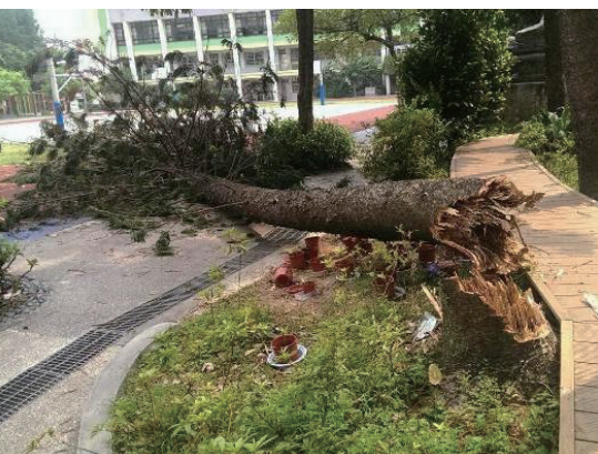
臺灣家白蟻啃食樹基部而造成小葉南洋杉倒塌(張仁傑提供)。
